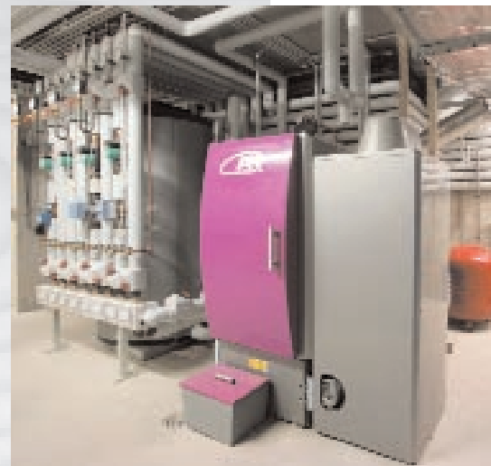
Bild 1: Holzpelletkessel zur Beheizung eines Bürgerzentrums
